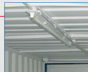
Rasvjeta i potezni prekidač
